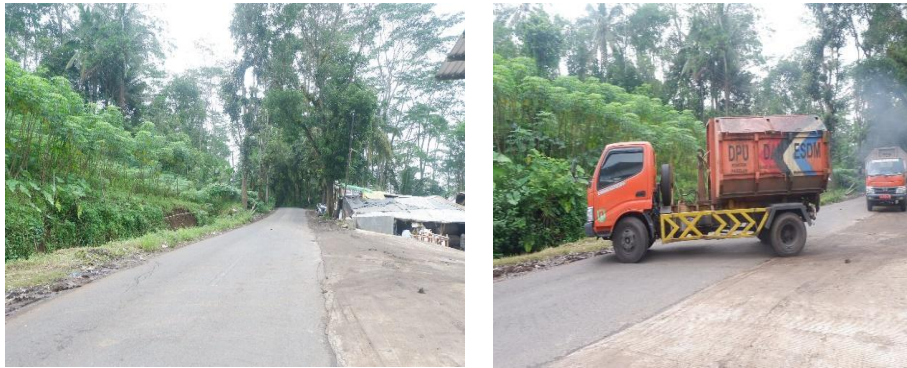
Gambar 10. Kondisi Akses Jalan Terdampak Truk Sampah
